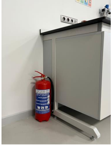
Yangın Söndürme Tüpü
